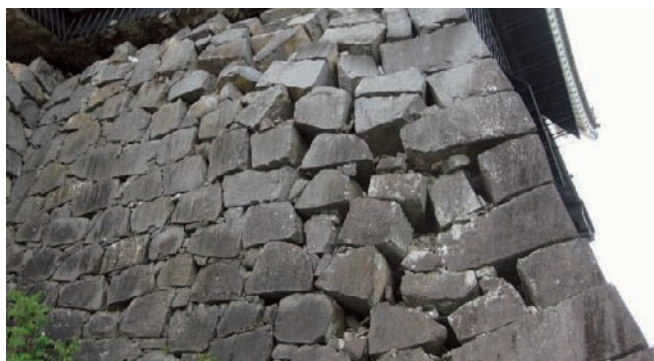
写真 6 孕み・緩みが生じた石垣
