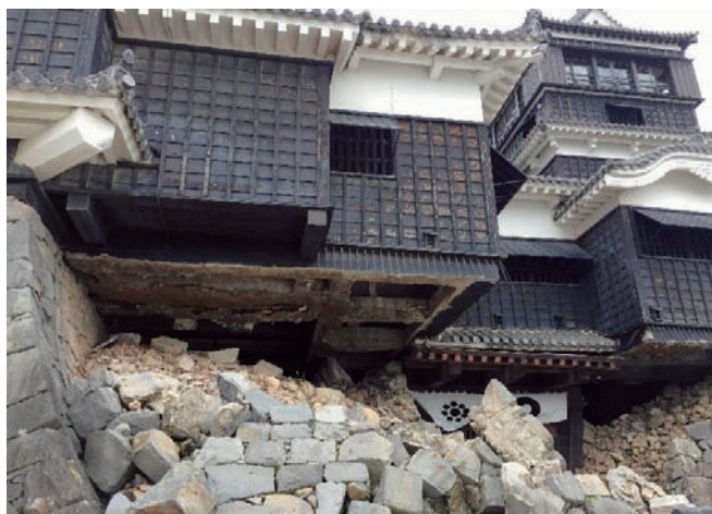
写真 5 崩壊した石垣
