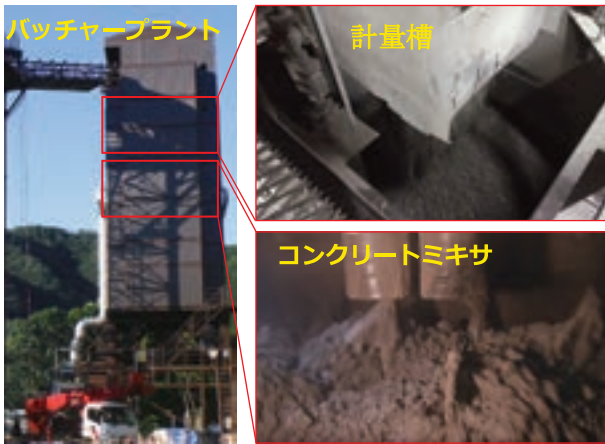
図 4-2 コンクリート製造設備
