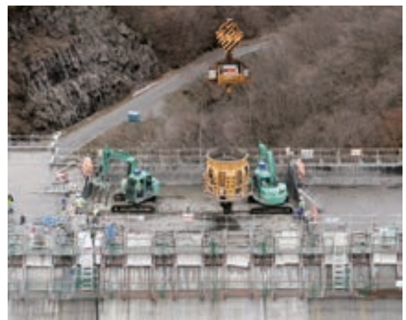
図 4-4 コンクリート放出状況
